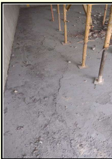
Figura 11 – Evidências de recalques em fundações periféricas aos pilares internos
