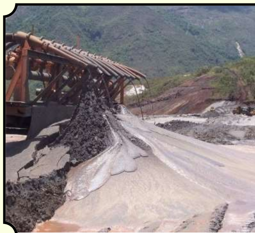
Bateria de hidrociclones em sistema de disposição de rejeitos
