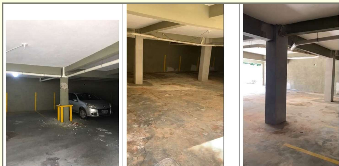
Figuras 12 a 14 – Pilar P9 rompido (esquerda) e pilares após término dos trabalhos
